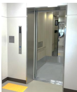
「新しく設置されたエレベーター」 みんなにやさしい学校を目指して!! 大切に使いしていきます
